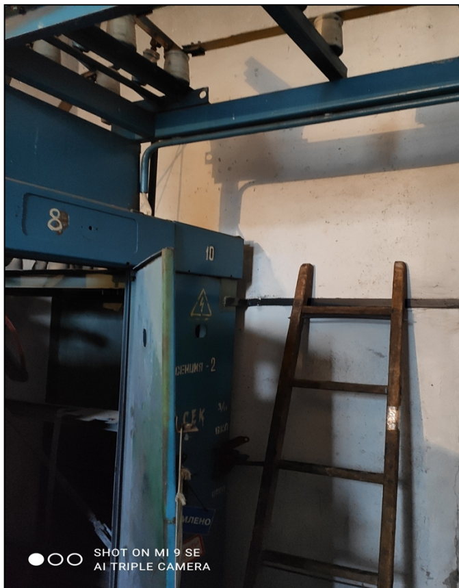
Место происшествия: шинный мост, приставная деревянная лестница
