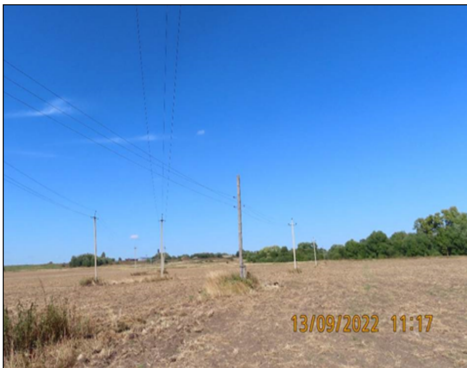
Место пересечения двух ВЛ. Пролет опор № 40-41 ВЛ 10 кВ № 1004 ПС Черкутино и опор № 83-84 ВЛ 10 кВ № 1003 ПС Черкутино
