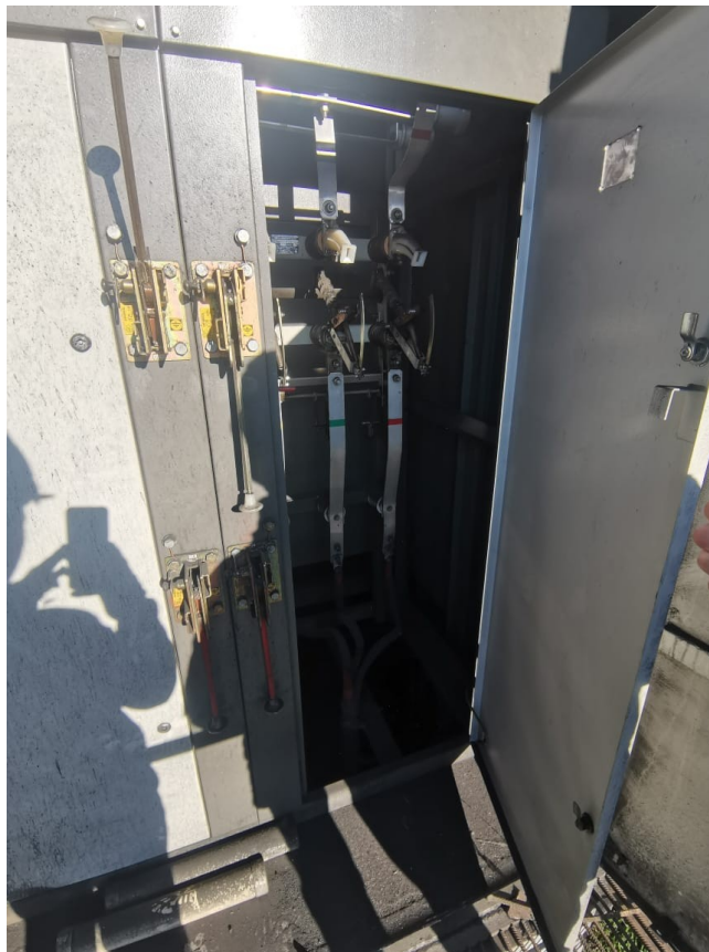
ТП 2453/1 прис. 6 кВ ввод № 2
